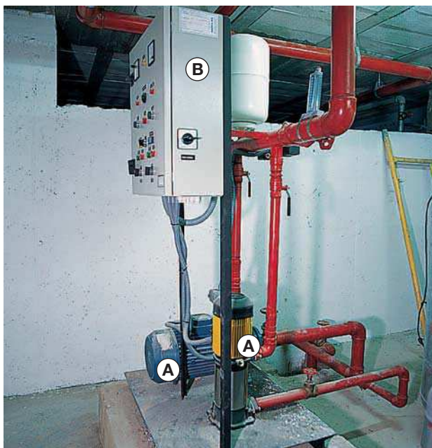
7. GRUPO DE PRESIÓN PARA RED DE BOCAS DE INCENDIO EQUIPADAS (BIE):
