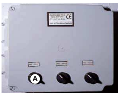
5. CUADRO DE MANDO DE ELECTROBOMBAS:
