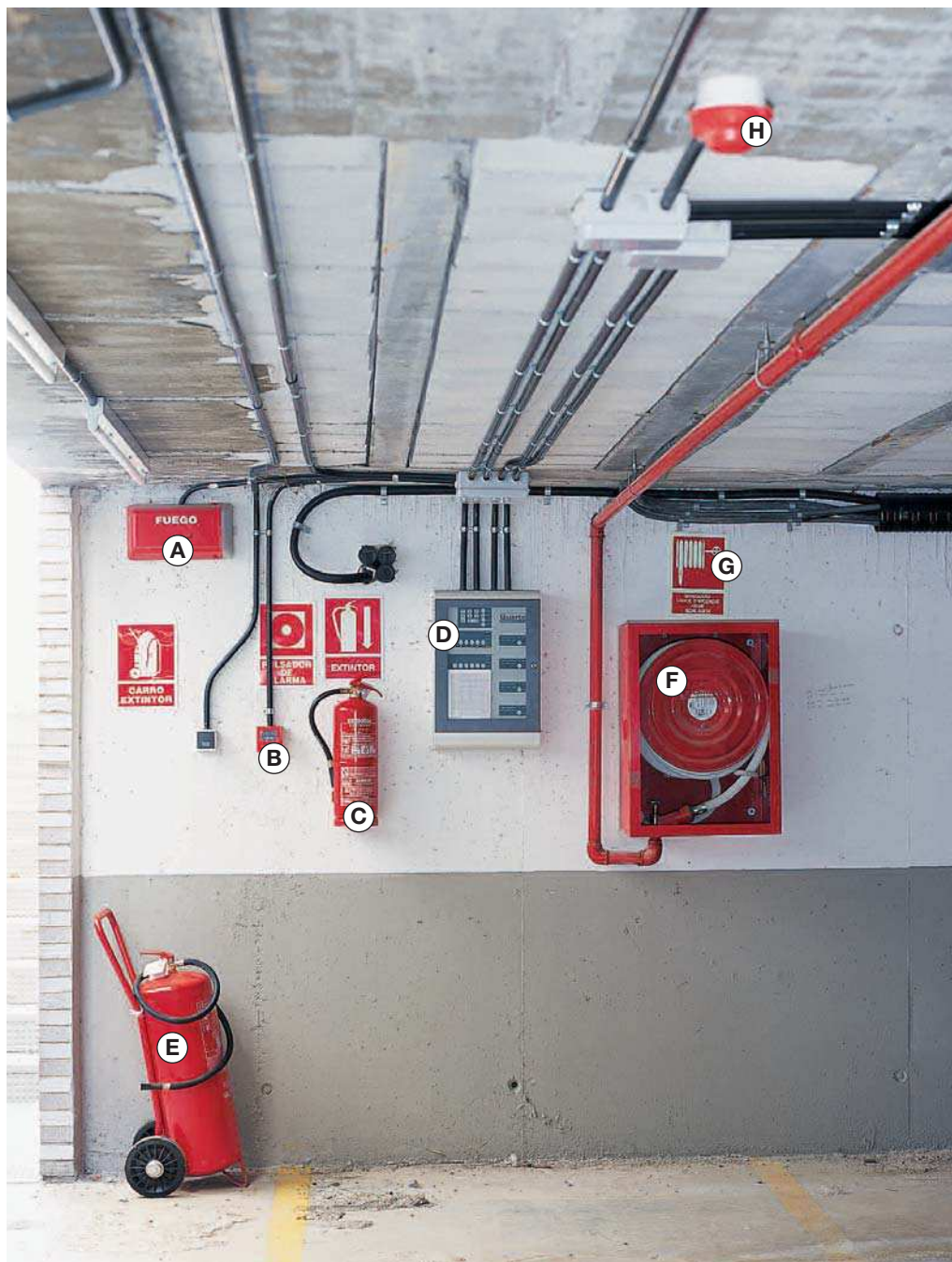
17. EQUIPOS E INSTALACIONES DE PROTECCIÓN CONTRA INCENDIOS:
