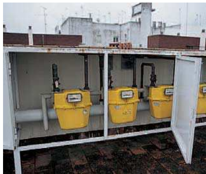
20. BATERÍA DE CONTADORES Y LLAVES DE CORTE.
