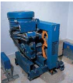
13. MAQUINARIA DE ASCENSOR.
